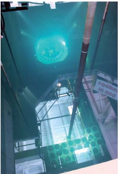
Перегрузка ОЯТ на «мокром» хранилище
